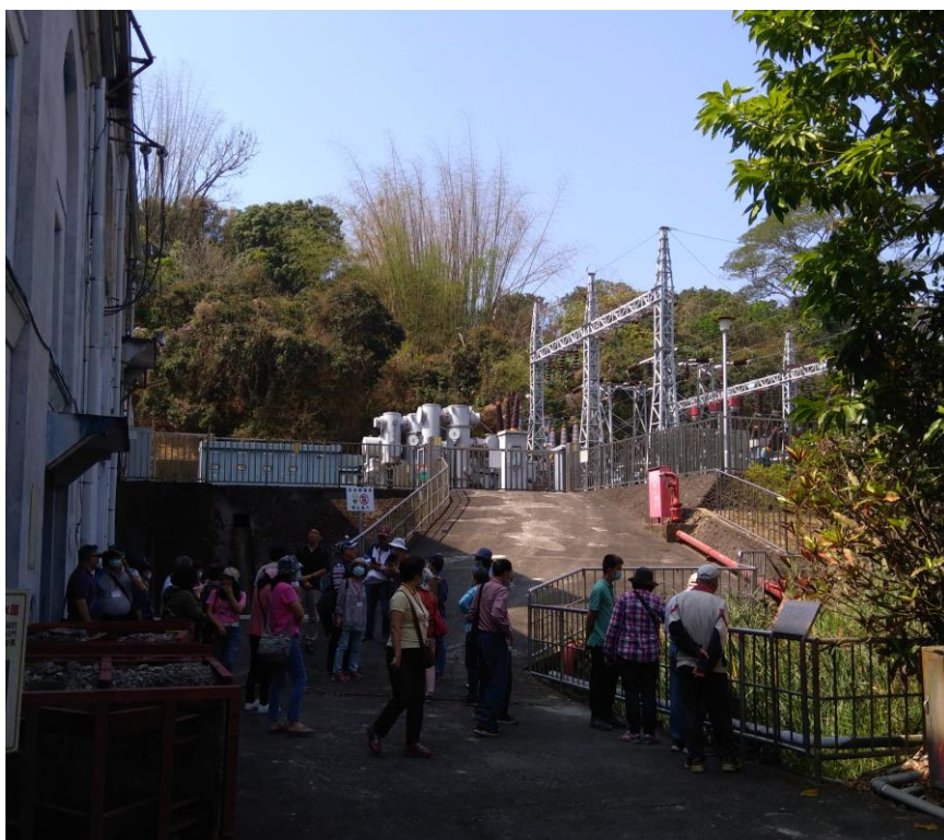
2021.4.16：發電廠旁之變電站，轉變為高壓電傳送遠方
