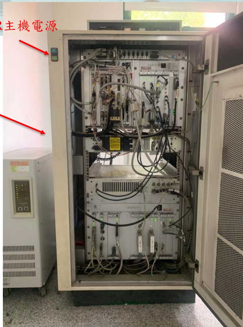
300 NMR Console 內部
