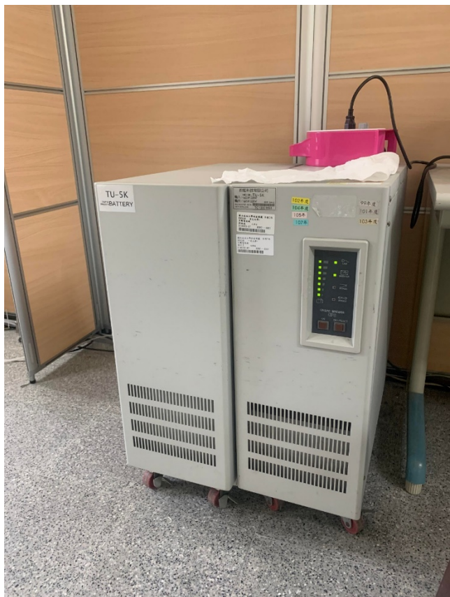
400 NMR UPS(不斷電系統)
